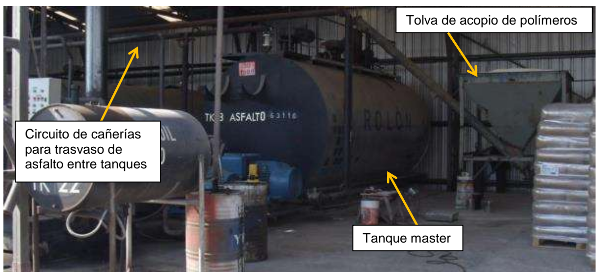
FOTO 17. INSTALACION DE LA PLANTA MODIFICADORA DE ASFALTO (BARADERO)
