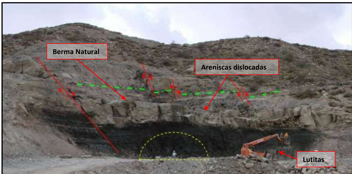
Figura 5: Sistema de fallamiento en el portal de entrada del túnel 3, donde se observan también los bloques de areniscas dislocados y la base de fangolitas de pobre calidad geotécnica.
