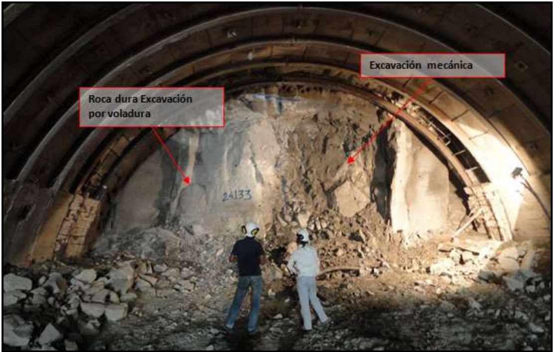
Figura 10: Mostrando la heterogeneidad del frente excavación en el túnel.
