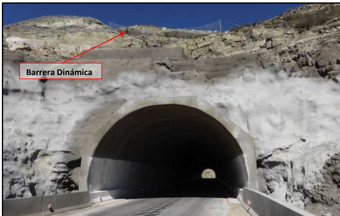
Figura 23: Sistema de protección de laderas para el portal de entrada del túnel 3.
