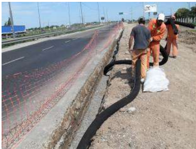
FOTO 1. SISTEMA DE DRENAJE
