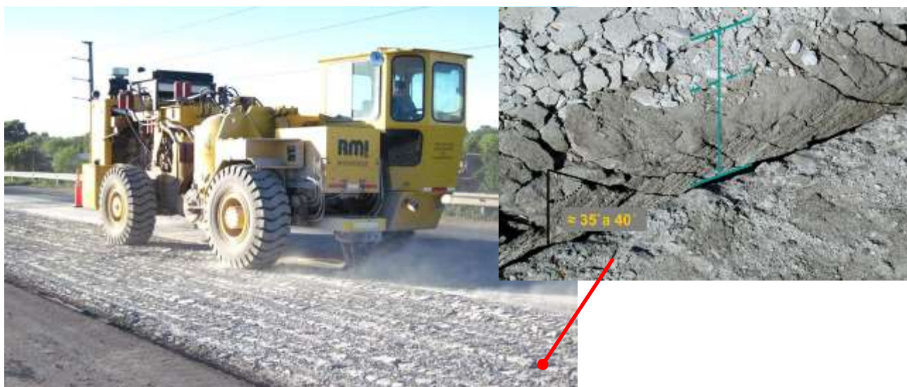
FOTO 2. FRACTURA DEL PAVIMENTO
