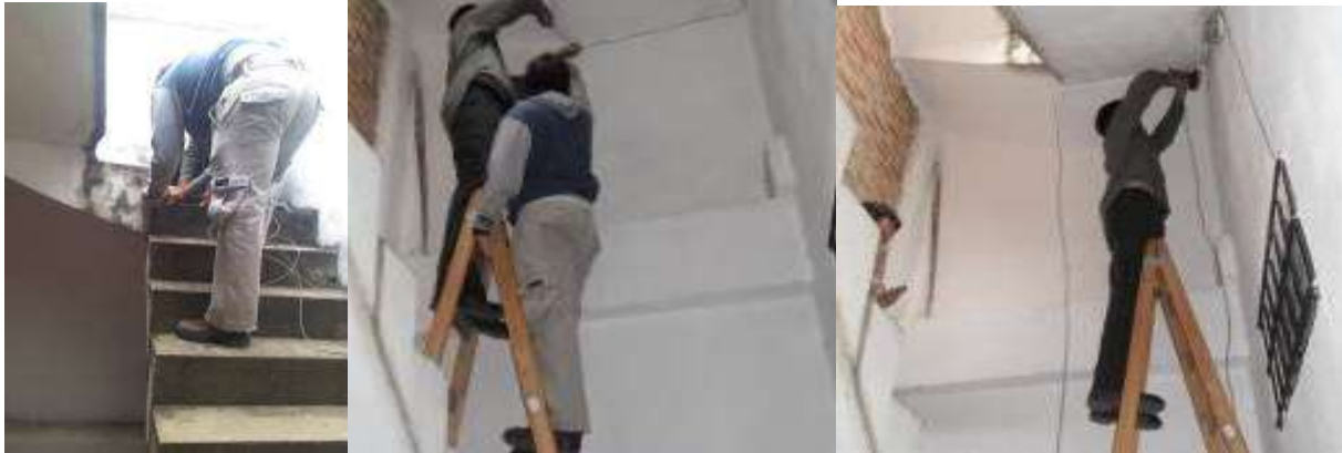
Imagen 3.3-6. Cableado desde la cámara hasta el DVR. Personal de DVP. Fuente: Autor
