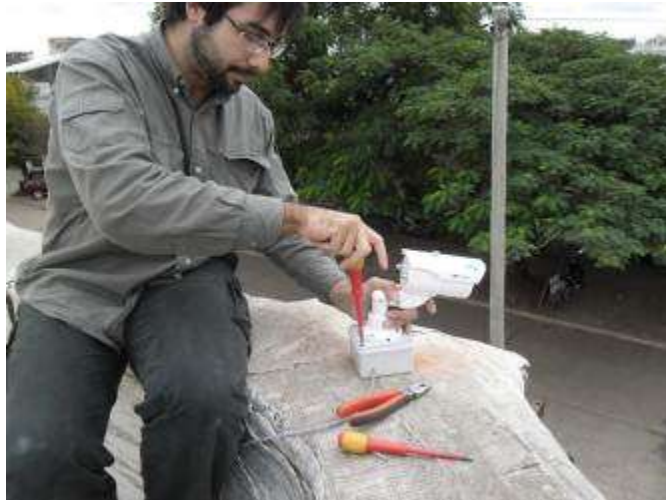
Imagen 3.3-3. Instalación de la cámara. Personal de la DVP. Fuente: Autor
