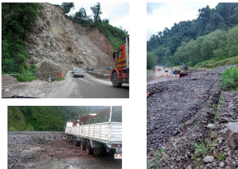
Figura 2. Cortes de la RP 307 por aluviones y derrumbes
