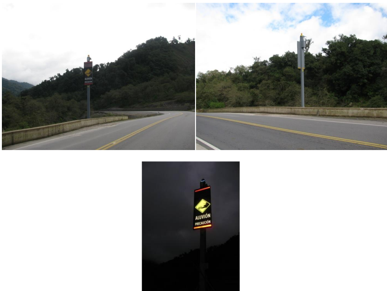
Figura 5. Postes de señalética inteligente en zona aluvional monitoreada
