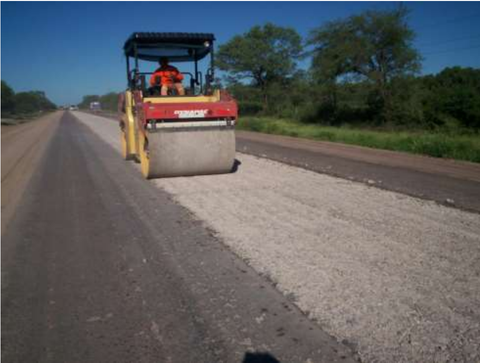
Imagen 29: Paso del Rodillo autopropulsado para acomodar las piezas producto de la demolición
