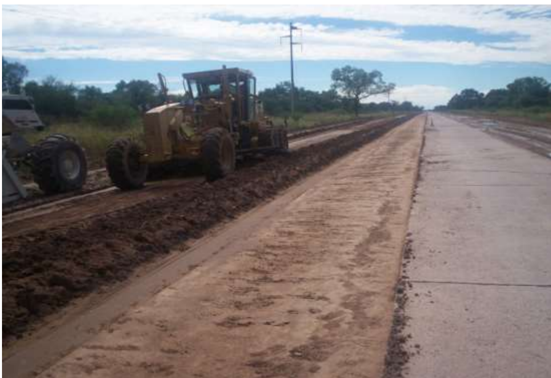
Imagen10: Apertura de caja para ensanche granular, con motoniveladora, entre Prog. 23000 a 19000 (AL).
