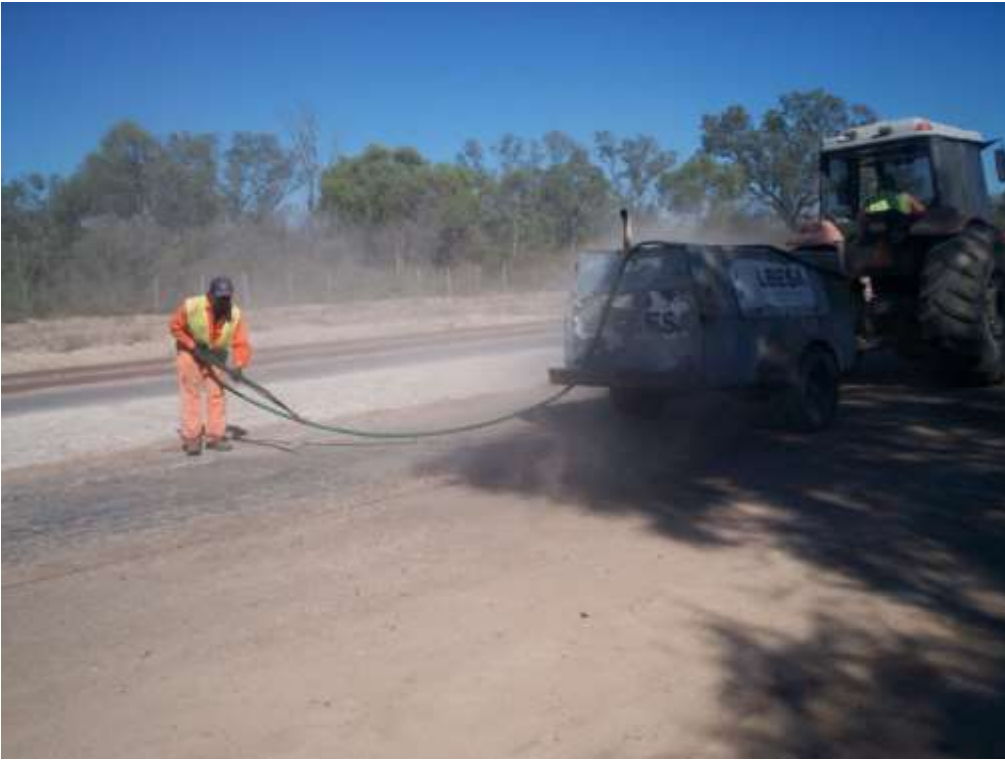
Imagen 31: Soplado de material suelto y polvo antes de realizar el riego de liga y la base negra
