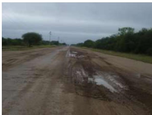
Imagen 2: Banquinas en mal estado
