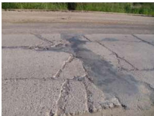
Imagen 1: Vista losas fracturadas
