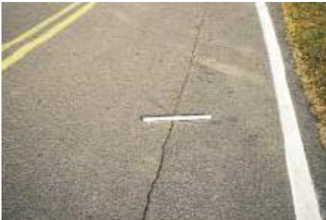
Fisuración por fatiga. Fisura longitudinal.
