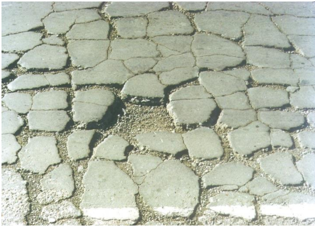
Fisuración por fatiga. Piel de cocodrilo.
